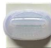
Luz del pasillo2
